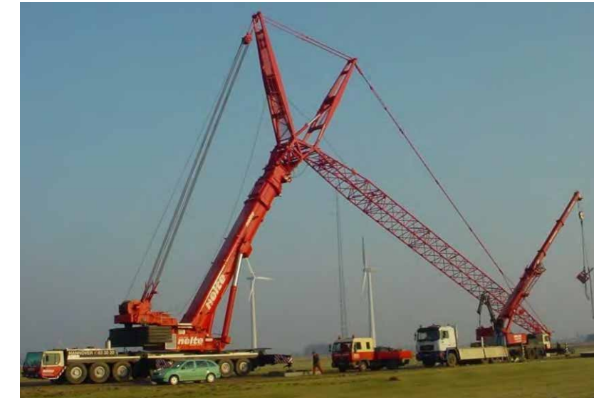
Photo 47 : Grues nécessaires au montage des aérogénérateurs et à l'assemblage des rotors (Source : SENVTON)
