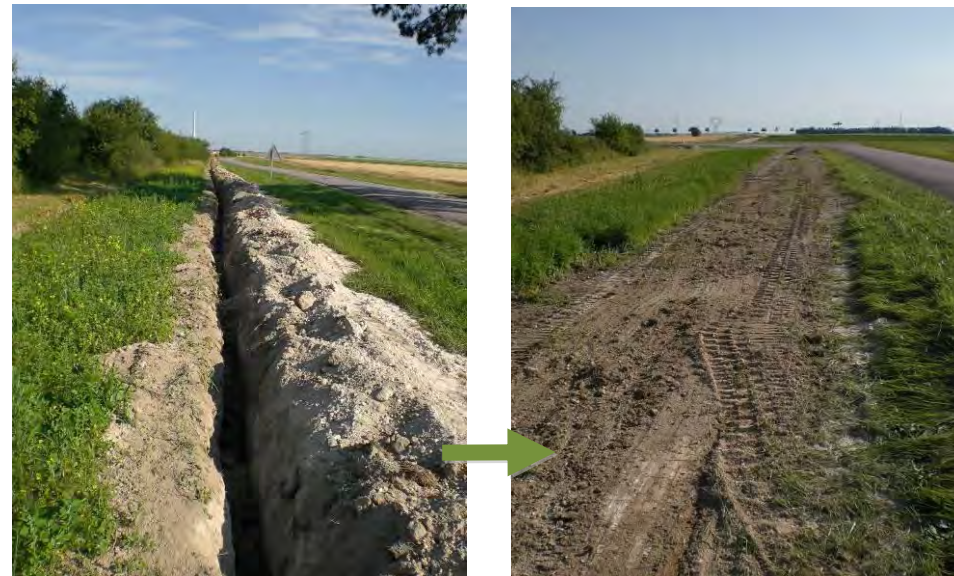
Photo 53 : Rebouchage de tranchée après passage des câbles électriques (Source : BE Jacquelin et Chatillon)
