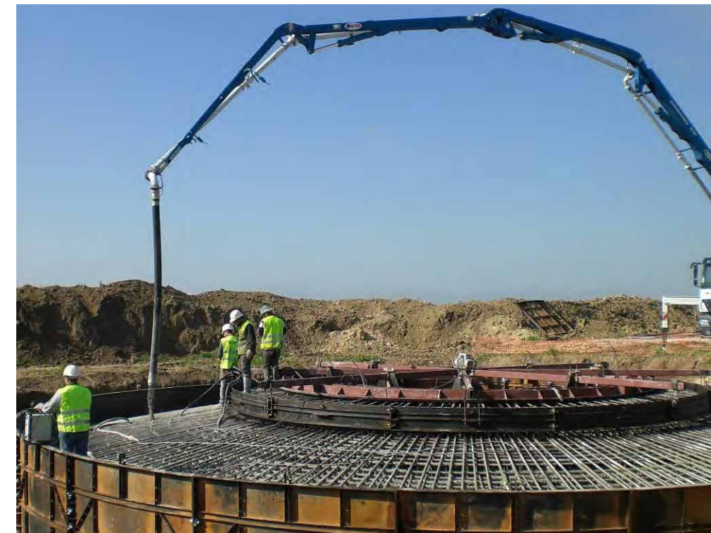
Photo 50 : Exemple de coulage du béton de fondation d'éolienne (Source : BE Jacquiel et Chatillon)
