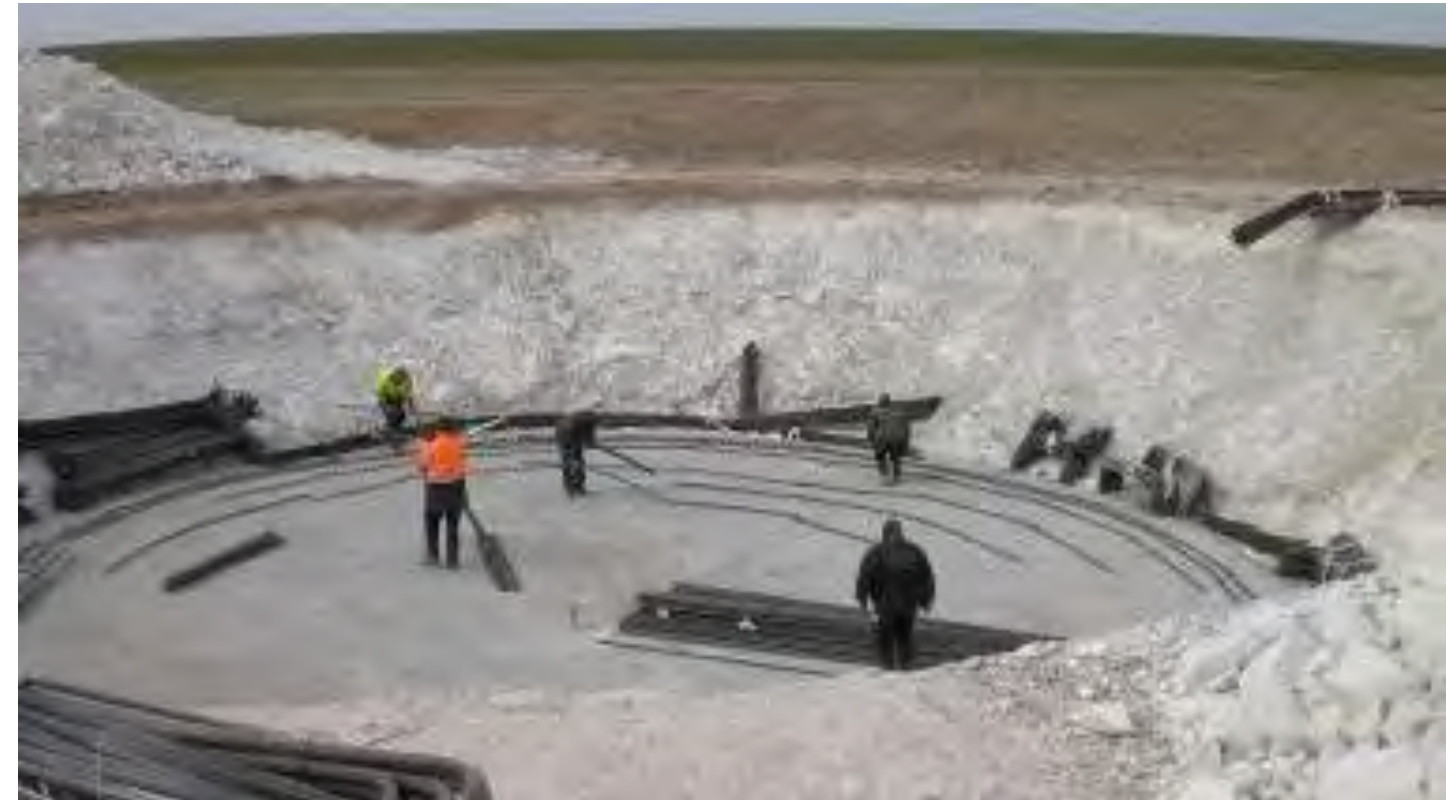
Photo 61 : Exemple de fondation à remettre en état
