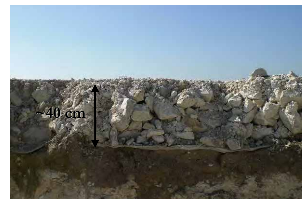
Photo 45 : Type de remblais utilisés pour le renforcement des chemins d'accès (Source : BE Jacquel et Chatillon)
